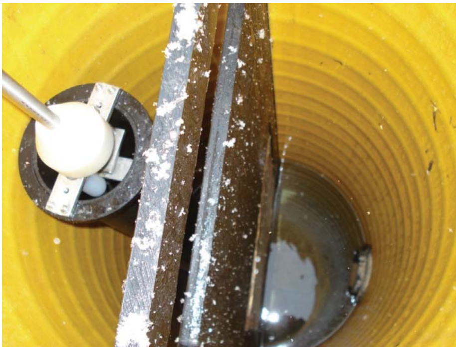
Abb. 3.2.3-1: Blick in die Regelungseinheit des Controlled Drainage (Foto: F. Koch)
